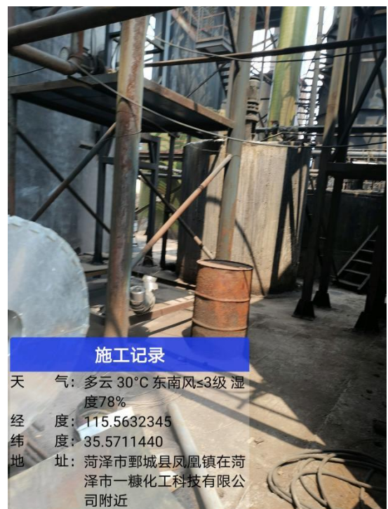
锅炉及废气处理设施
