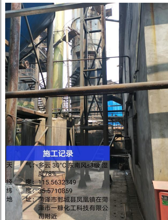
锅炉及废气处理设施
